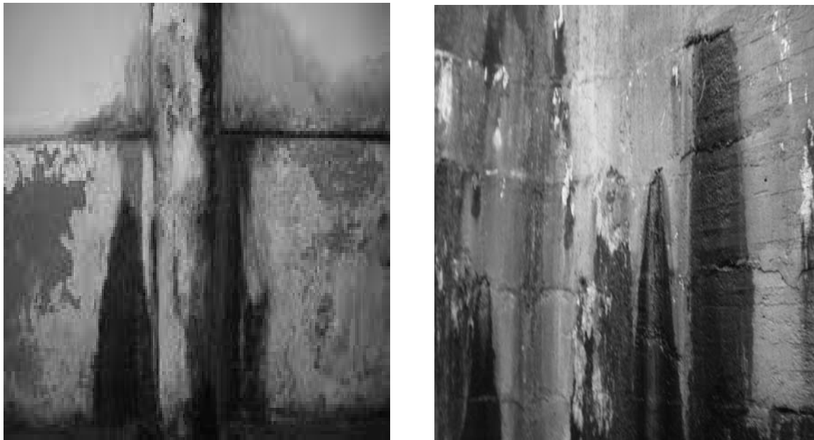
Рисунок 1 - Місця активних протічок на залізобетонних конструкціях
