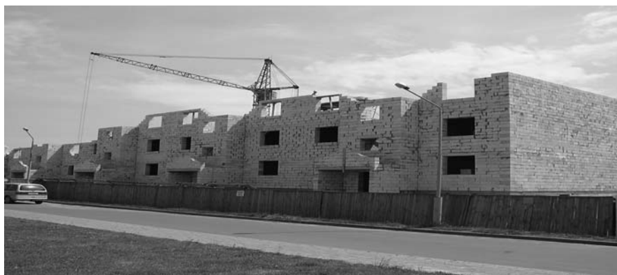
Рисунок 1 – Строительство многоквартирного жилого дома с несущими стенами из ячеистобетонных блоков в районном центре Клецк (Минская обл.)
