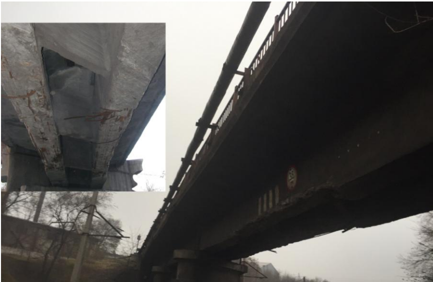
Рис. 3. Пошкоджені балки прогонової будови.
