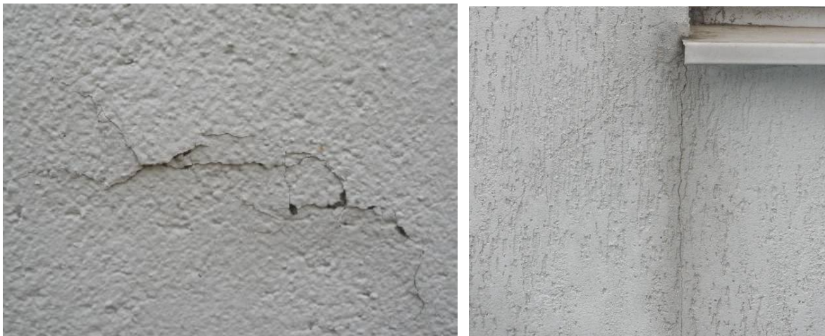
Рис. 1. Утворення тріщин на поверхні штукатурного шару фасадної теплоізоляції
