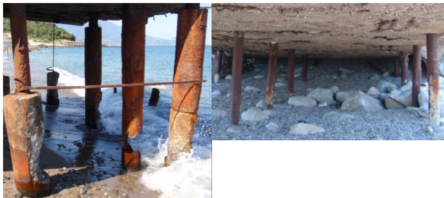
Рис. 3. Корозійні та механічні пошкодження трубобетонних опор споруди пірсу
