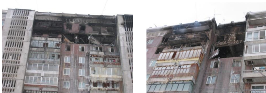
Рис. 1. Фрагмент фасада здания по осям « B_c » ( a ) и « A_c » ( б ) после взрыва
