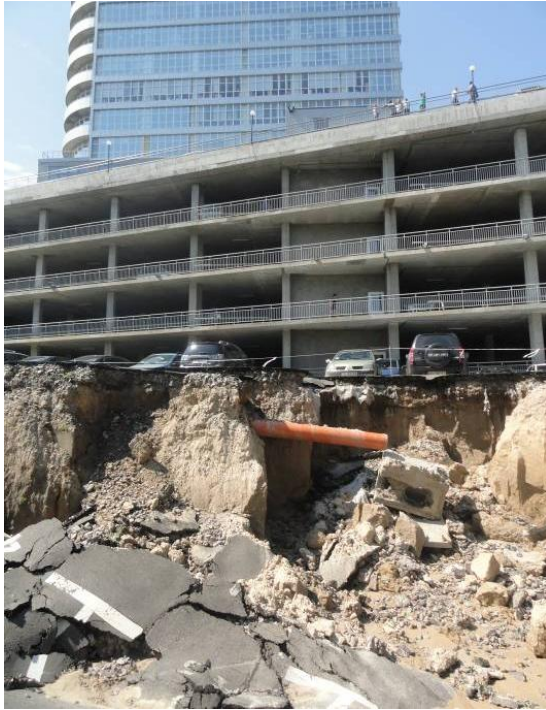
Рис. 3. Фото багатоповерхової будівлі та аварійного стану схилу
