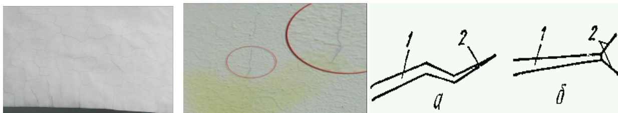
Рис. 3. Развитие трещин в штукатурном покрытии при эксплуатации
