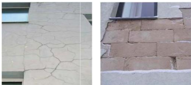
Рис. 11. Разрушение и отслоение штукатурного покрытия от газобетонной кладки
