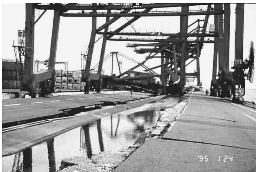
Рис. 3. Значительные деформации территории причала от действия землетрясения
