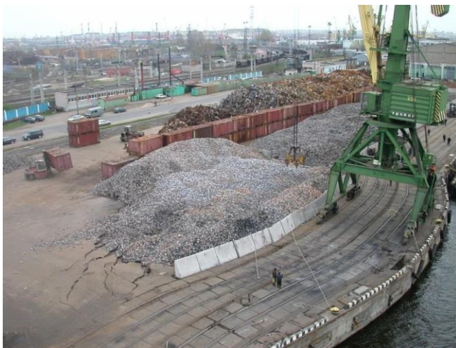
Рис. 2. Деформация причала из-за перегрузки
