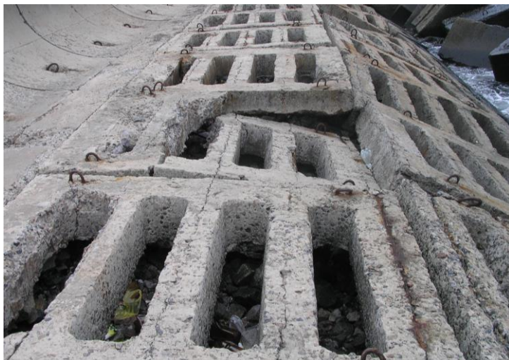
Рис. 1. Разрушение щелевой плиты в результате выноса грунтового основания
