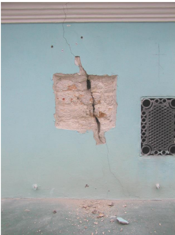
Рис. 6. Тріщина на північному фасаді ззовні
