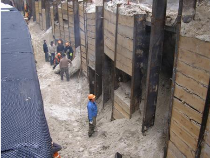
Рис. 4. Вивали ґрунту між стояками зовнішньої підпірної стіни в котлован
