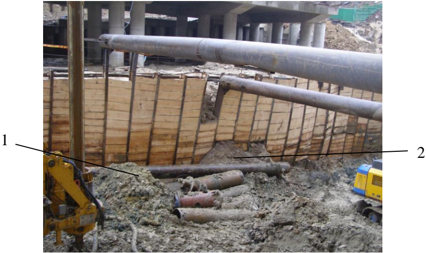
1- місця замокання дощок забірки, 2- випирання ґрунту Рис. 6. Замокання та випадіння дощок забірки з вивалом ґрунту
