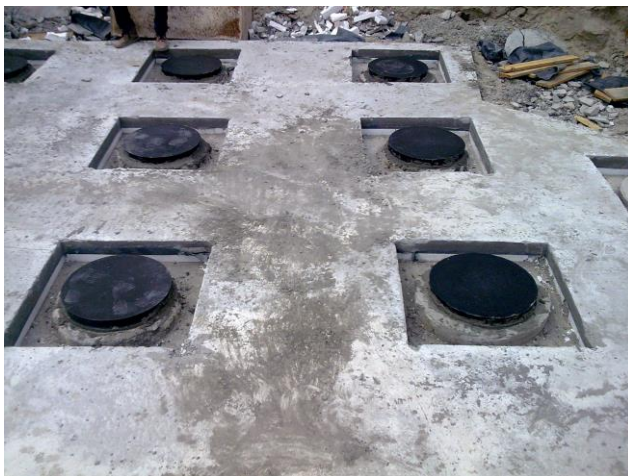
Рис. 9. Общий вид системы виброзащиты высотного здания на Оболонском проспекте в г. Киеве (резиновые виброизоляторы диаметром 500 мм установленные на оголовках свай диаметром 620 мм)
