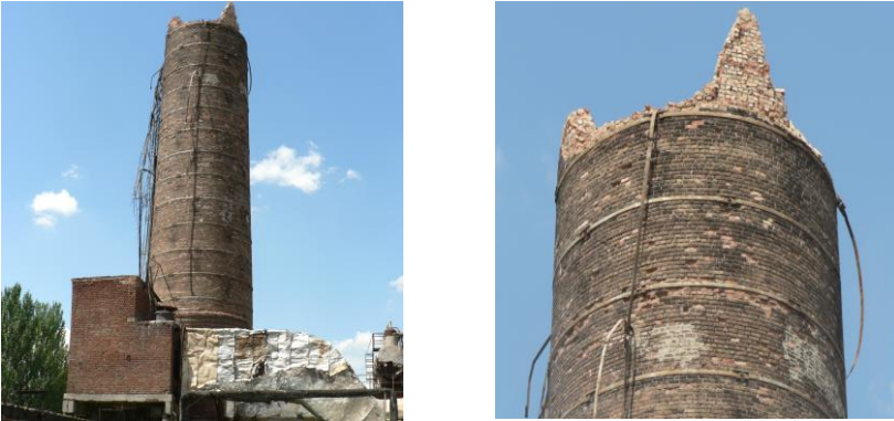
Рис. 2. Загальний вигляд і фрагмент димової труби котельні по вул. Індустріальна, 59 в м Мелітополь після обвалу стовбуру труби
