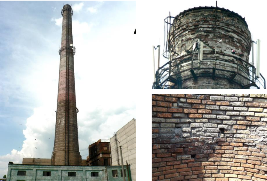
Рис. 1. Загальний вигляд і фрагменти стовбура труби з руйнуванням цегляної кладки та футеровки котельної по вул. Луначарського, 61в м. Мелітополь
