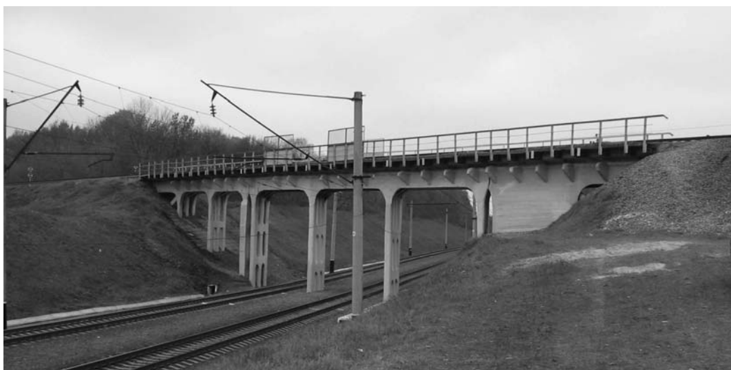
Рис. 6. Общий вид путепровода, расположенного на 802 км участка Гребёнка – Черкассы, после проведения ремонтных работ
