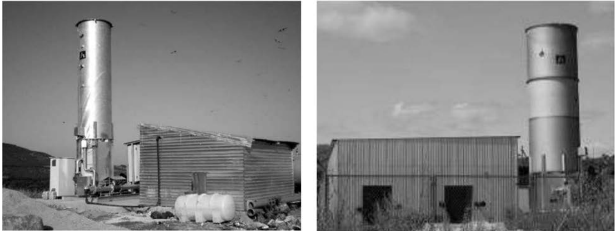
Рис. 2. Факельні установки HOFGAS-Ready у системах утилізації сміттєвого газу
