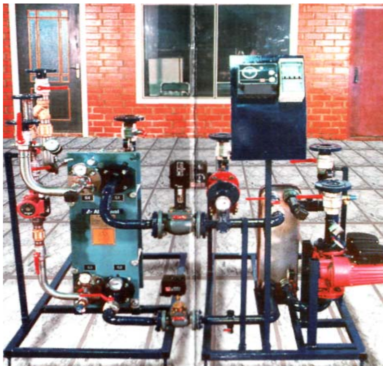
Рис. 2. Общий вид установки ИТП
