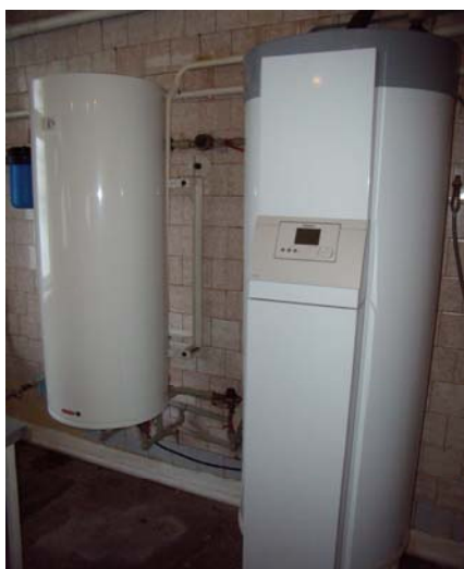
Фото 11. Накопичувальний блок у приміщенні (електричний водонагрівач в резерві)
