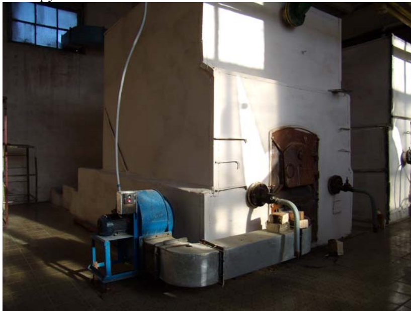
Фото 2. Котел НИИСТУ-5 працює на брикетах
