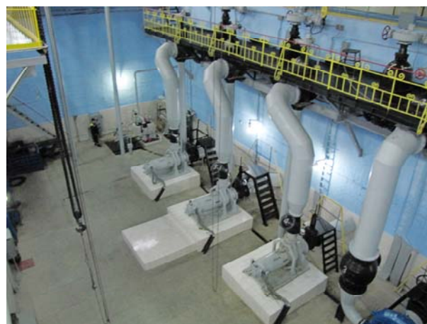
Фото 6. Насосне обладнання КНС № 2А.
