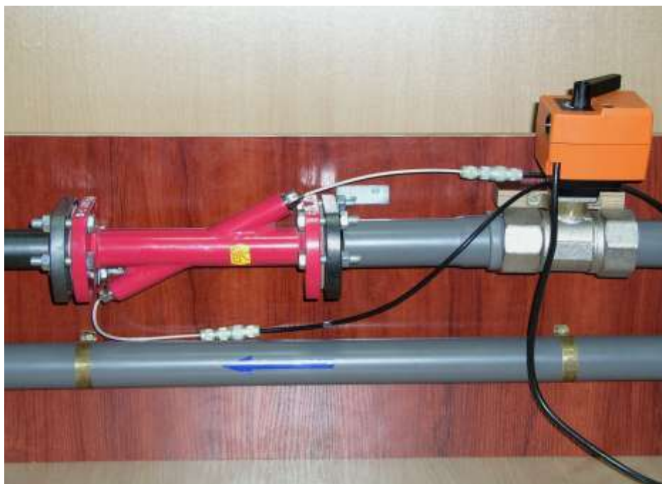
Рис. Фрагмент прямого та зворотного трубопроводів теплового пункту з витратомірною ділянкою тепловодолічильника СВТУ-10М і клапаном вузла регулювання витрат теплоносія (макет)
