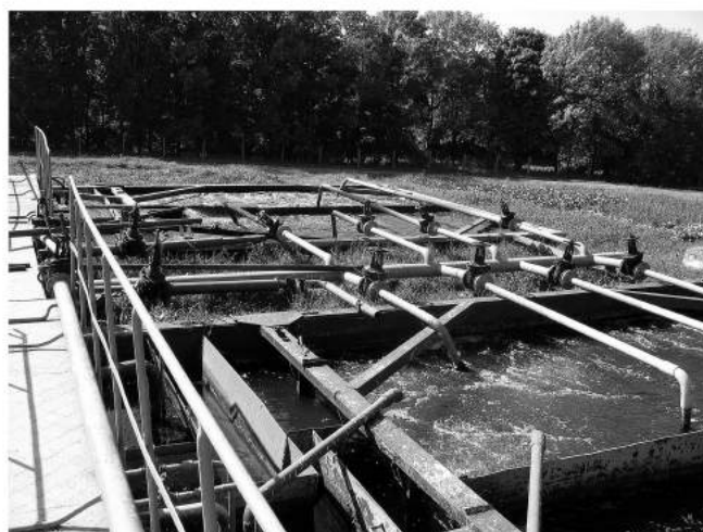
Рис. 4. Очистные сооружения пос. Юльевка
