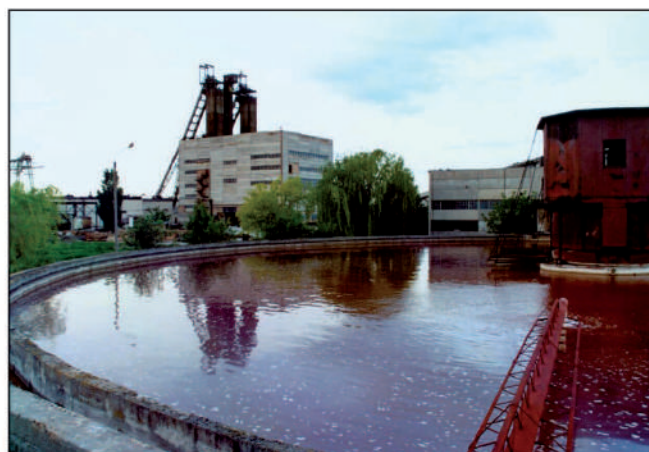
Рисунок 2 – Установка очистки шахтных вод на Смолинской шахте ГП «ВостГОК»
