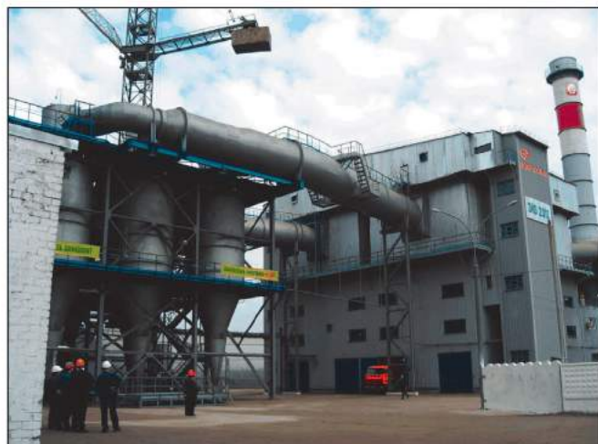
Рисунок 4 – Общий вид газоочистки
