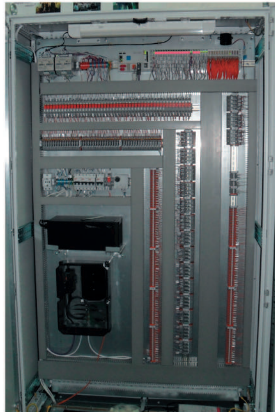
Рисунок 2 – Шкаф контроллерный ПТК АСУ ТП модернизированной системы золоулавливания и опытно-промышленной установки сероочистки энергоблока № 10 Луганской ТЭС
