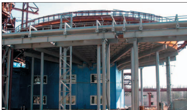
Рисунок 9 – ГУП «ЛПЗ» в г. Ярцево. Радиальный отстойник с камерой флокуляции диаметром 30 м и насосной станцией
