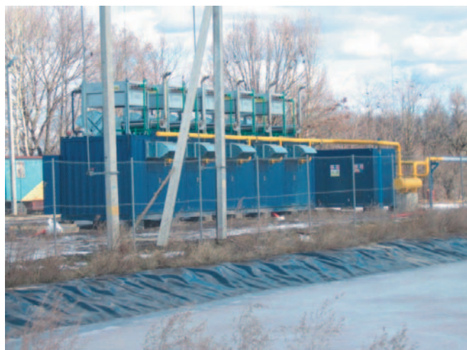
Рисунок 4 – Комплекс по переработке свалочного газа производительностью 1 МВт по выработанной электроэнергии
