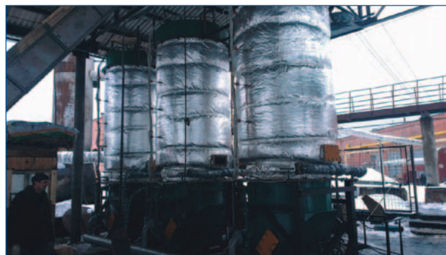
Рисунок 2 – Система газогенераторов эксплуатационной мощностью по 2 МВт
