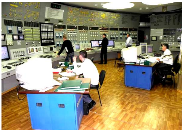
Рис. 13. Общий вид БЦУ (отдельного специфического «командного пункта») одного из энергоблоков с тепловой мощностью 1000 МВт на Южно-Украинской АЭС [17]
