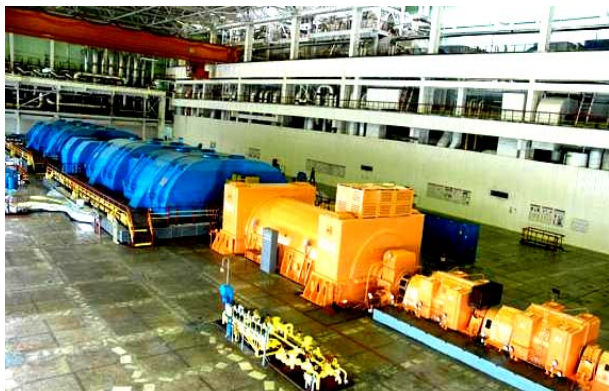
Рис. 12. Общий вид машинного зала энергоблока тепловой мощностью 1000 МВт Южно-Украинской АЭС [17]
