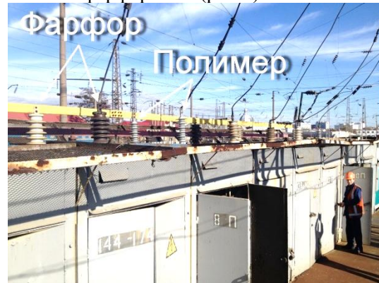
Рис. 1. Пункт группировки станции Львов, укомплектованный керамическими и полимерными проходными изоляторами
