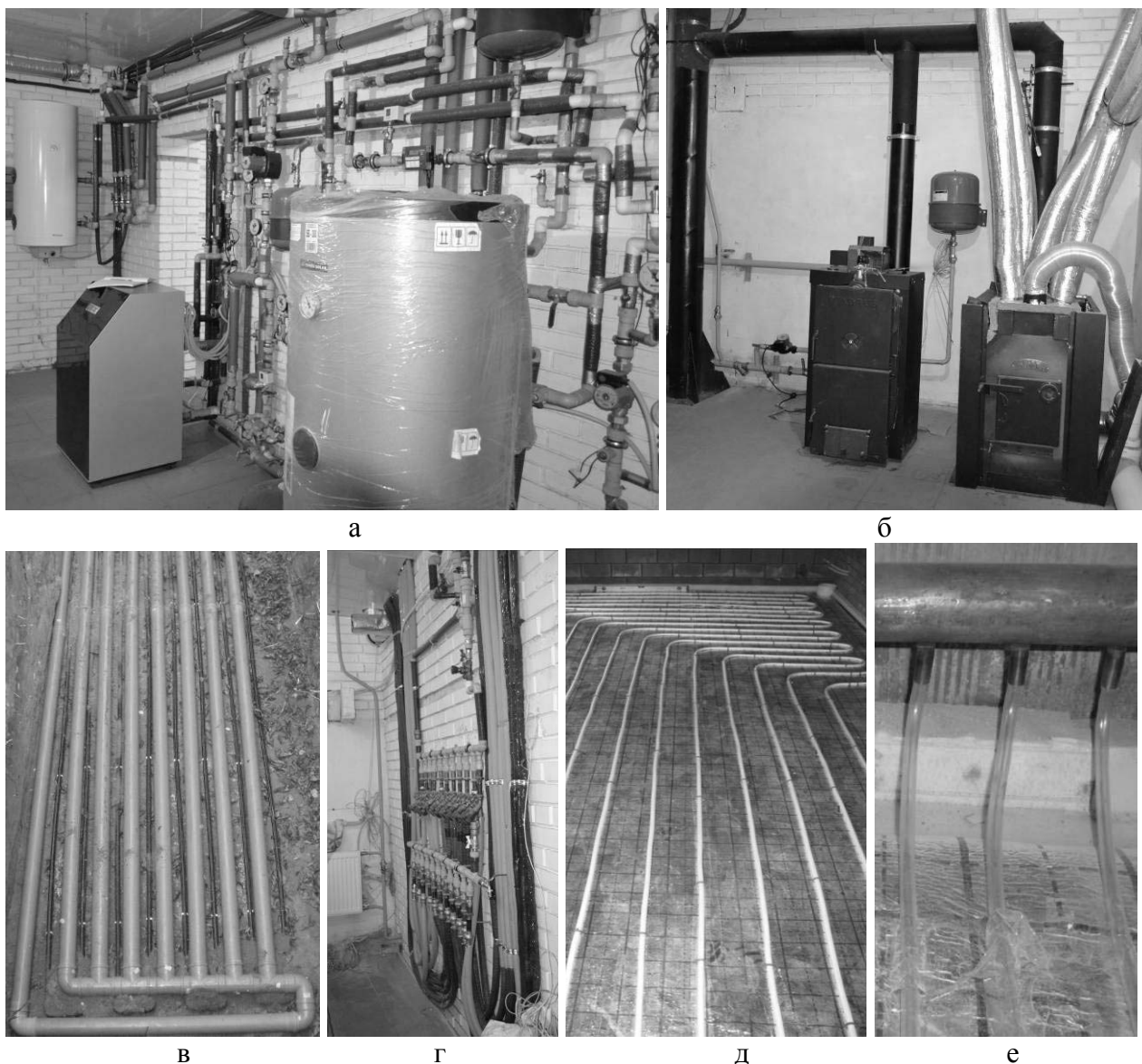
Рис. 3. Фотографии фрагментов систем теплообеспечения на основе теплового насоса, котла и печи: а – гидравлическая система коммутации источников теплоты; б – твердотопливный котел и печь; в – грунтово-воздушный теплообменник и грунтово-жидкостный коллектор; г – гребенка распределения теплоносителя по контурам отопления; д – Г-образные контура водяной системы типа теплый пол; е – фрагмент коллектора и капиллярных труб водяной системы теплый пол
