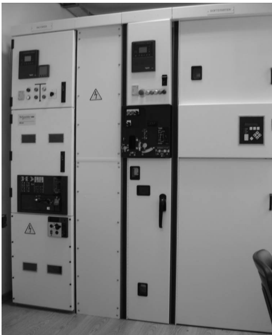
Рис. 3. Высоковольтные секции главного распределительного щита
