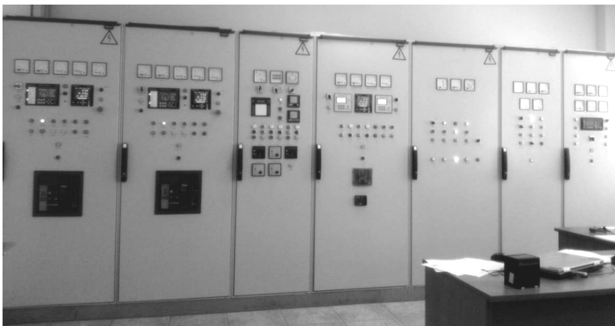
Рис. 1. Общий вид 1 – 7 секций главного распределительного щита
