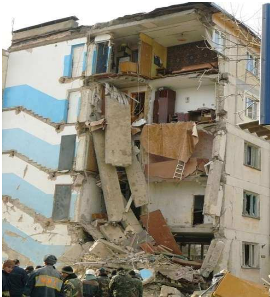
Рис. 1 Зруйнований будинок у Євпаторії
