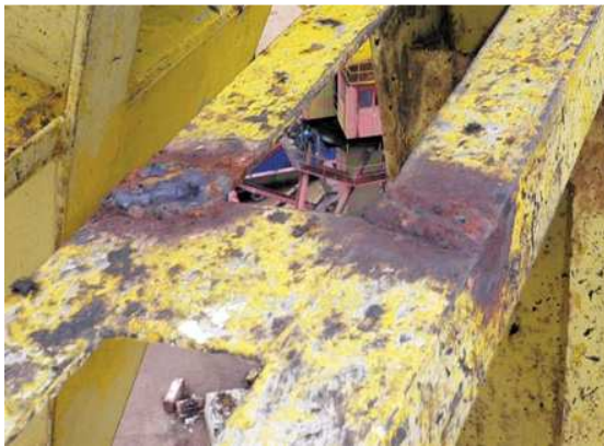
Рис. 5. Руйнування оголовка стріли Fig. 5. The destruction of head boom
