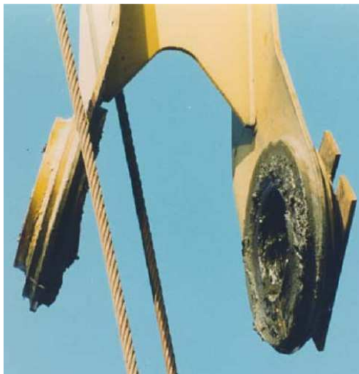
Рис. 2. Зруйнований шарнір «тяги коромисла–стріла» Fig. 2. Ruined hinge «Rod rocker-boom»
