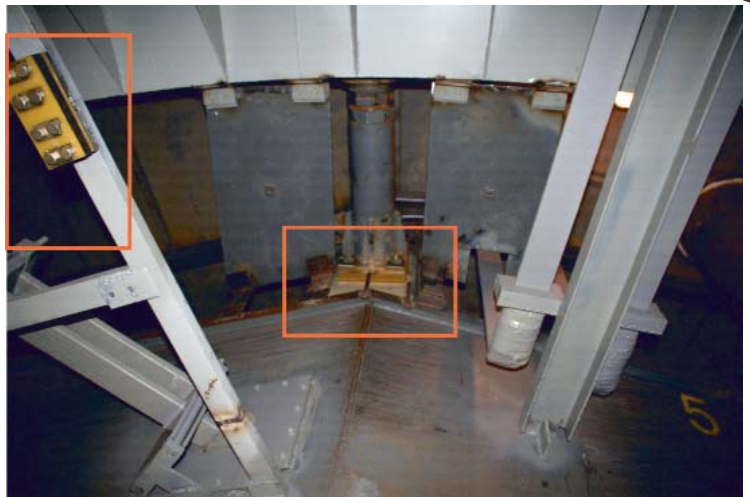
Рис. 4. Ізоляційні перемички на металоконструкціях в камері холодного повітря
