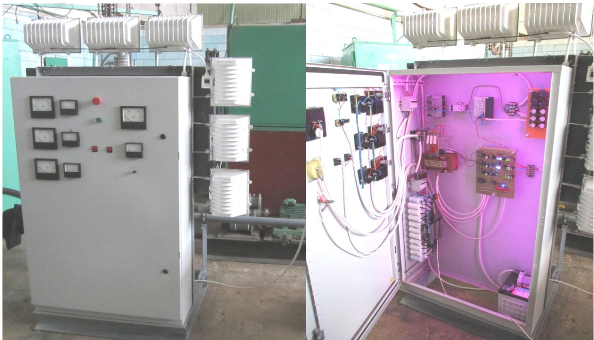
Рисунок 5 – Система силового підключення, контролю та регулювання електроенергії, що виробляється
