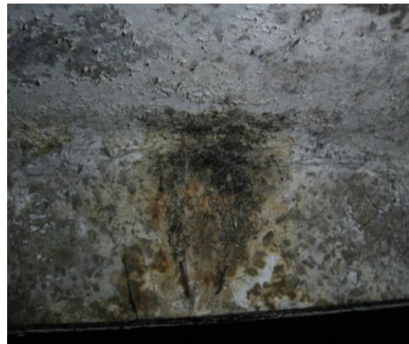
Рис. 8. Чорна пліснява на внутрішній поверхні плит покриття
