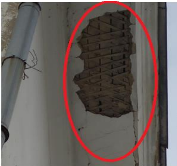
Рис. 5. Характерні руйнування карнизів.
