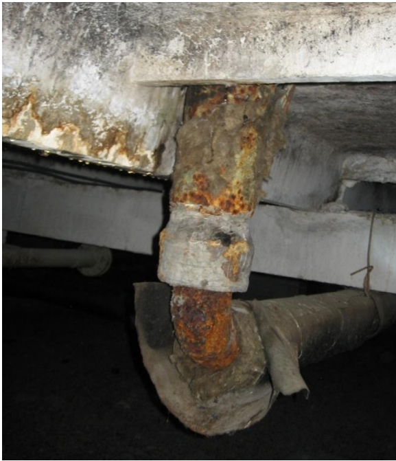
Рис. 9. Чорна пліснява на внутрішній поверхні плит покриття та корозія труб
