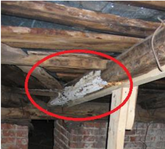
Рис. 4. Руйнування кровляної системи даху
