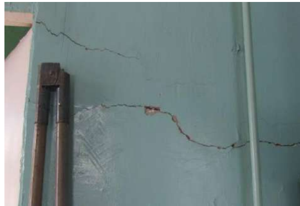
Рис. 4. Горизонтальные трещины в кирпичной кладке
