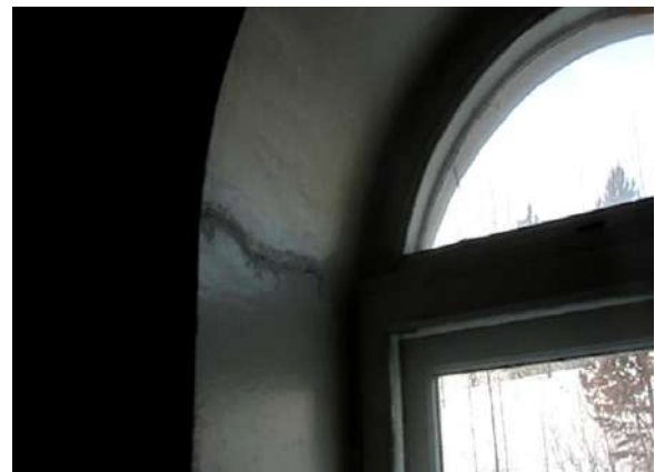
Рис. 5. Наклонная трещина в кирпичной кладке стены
