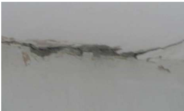
Рис. 2. Разрушение целостности раствора заделки монтажных швов между плитами покрытия (перекрытия)
