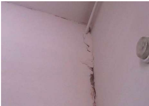
Рис. 1.Вертикальная трещина в кирпичной кладке стены
