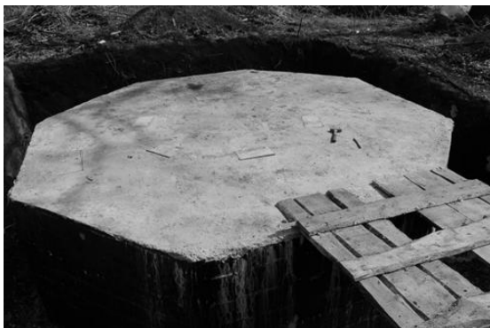
Рис. 1. Загальний вигляд монолітного залізобетонного фундаменту, який зазнав впливу заморожування
