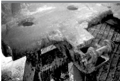
Рис. 3. Корозійне зношування консольної частини надресорної балки візка електропоїзда ЕР1 зав. № 033 (січень 2005 року)
