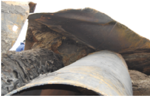
Рис. 1. Характерний приклад гільйотинного руйнування труби газопроводу “Уренгой – Помари – Ужгород” (2007 р.)
