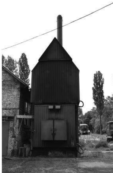
Рис. 1. Загальний вигляд котельні з теплогенератором RAU-600M, що працює на солом'яних тюках в ННЦ «ІМЕСГ»
