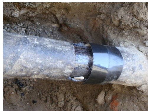
Рисунок 4 – Вигляд створеного відшарування ізоляційного покриття
