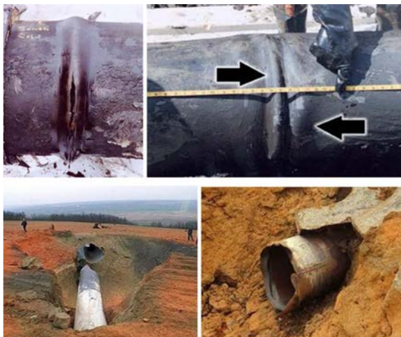
Рисунок 1 – Приклади порушення геометричності та цілісності трубопроводів внаслідок геологічних процесів
