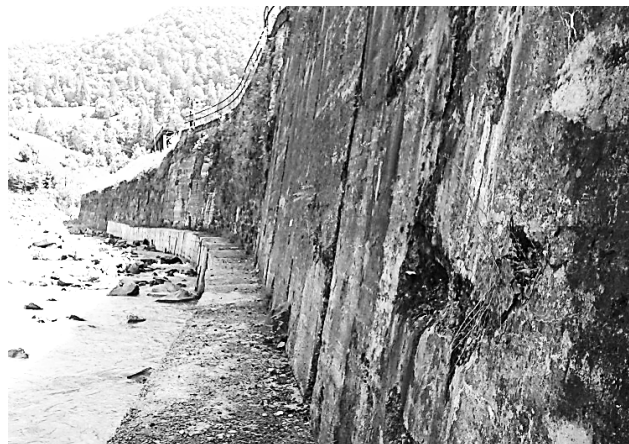
Рис. 6. Пошкоджена бетонна частина низової стінки
