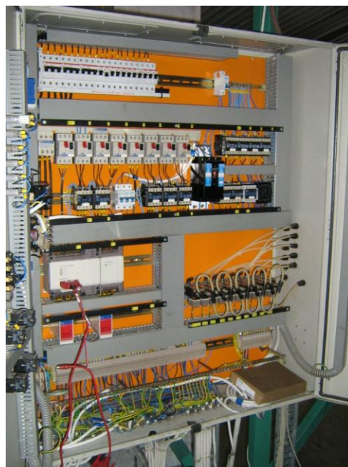
Рис. 5. Шафа автоматичного керування заводом
