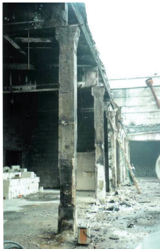
Рис. 1. Вигляд приміщень будівлі після часткового обвалення конструкцій покриття.
