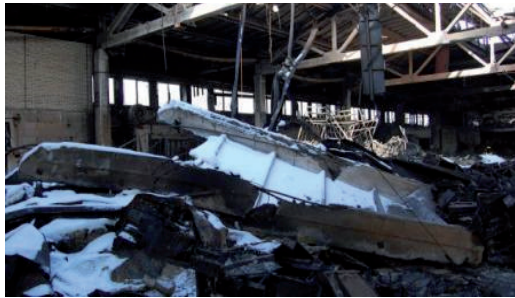
Рис. 2. Часткове обвалення конструкцій покриття.
