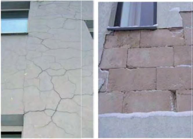
Рис. 11. Разрушение и отслоение штукатурного покрытия от газобетонной кладки
