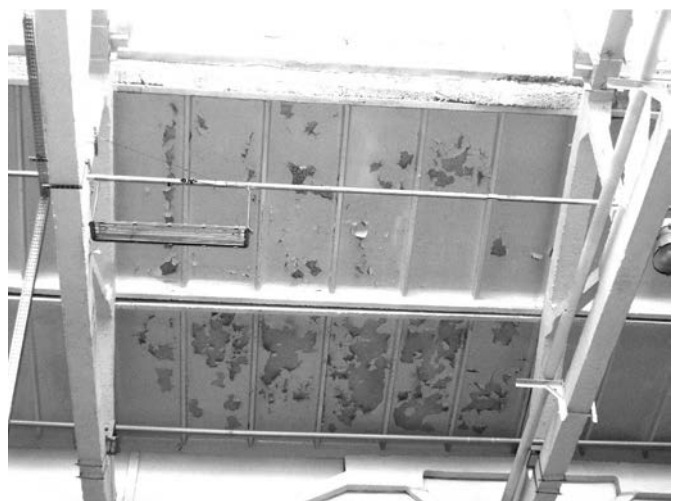
Рис.8. Характер відшарування водоемульсійної фарби з полицок плит по скату даху.
