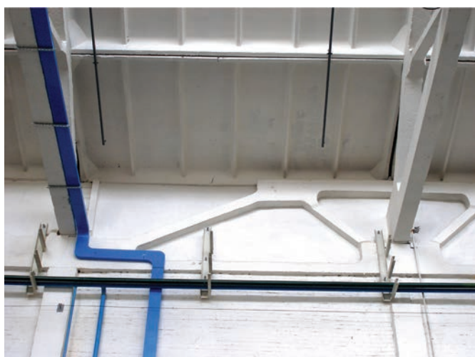
Рис.11. Вертикальні тріщини шириною до 3мм в прольоті, прогин – 40 мм, плита в осях „8-9” біля осі „Б” – аварійна по одному поздовжньому ребру.
