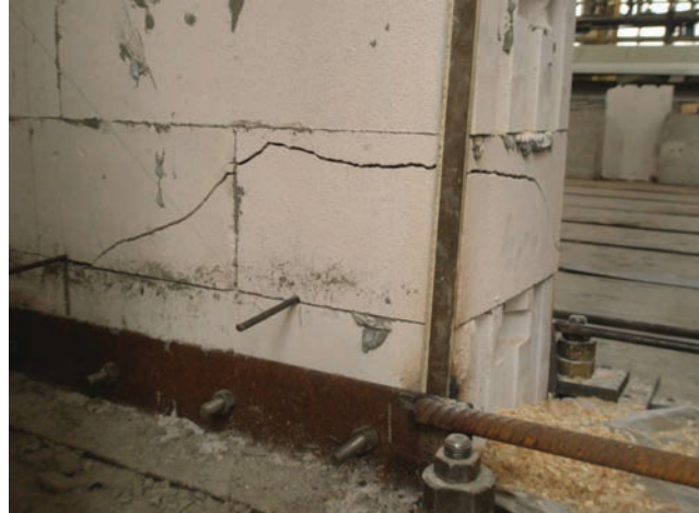
Рис.10. Характер разрушения простенка (образование и раскрытие трещин в газобетонных блоках нижних рядов кладки).
