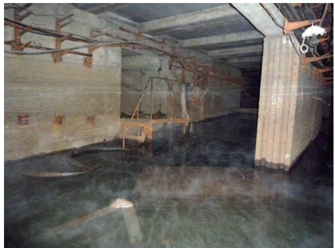
Рис. 4. Затоплена ділянка колектора
