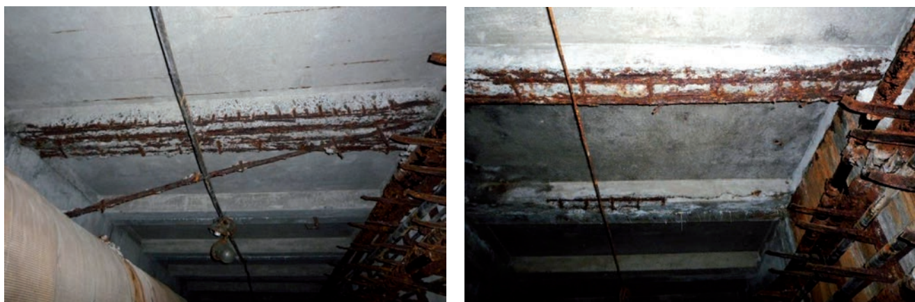
Рис. 6. Сколений захисний шар бетону з оголенням і корозією арматури плит перекриття
