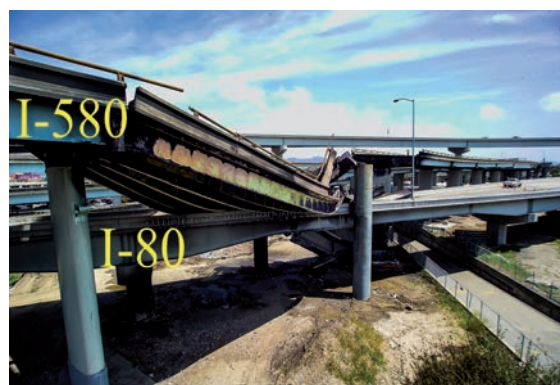
Рис. 1. Обрушение моста BayBridge после пожара [3]
