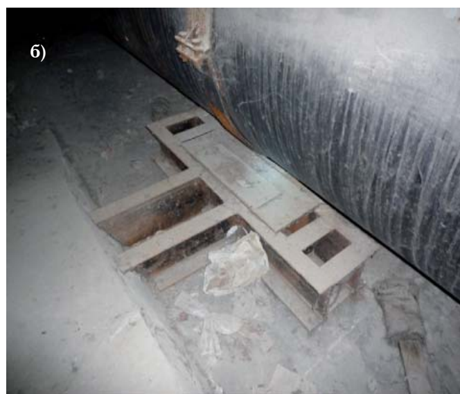
Рис. 15. Руйнування внаслідок корозії (а) та відсутність (б) опор водоводу
