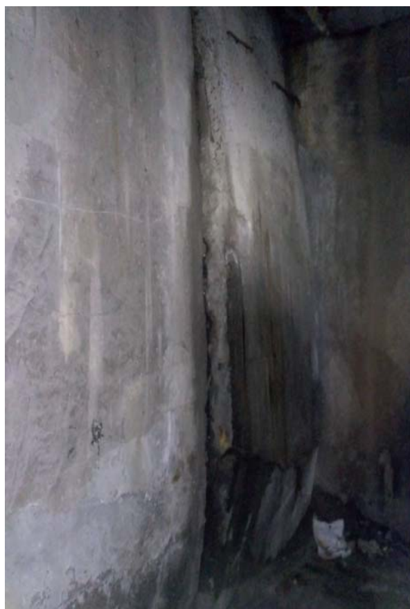
Рис. 14. Руйнування панелі стінового огородження правобережної кінцевої ділянки
