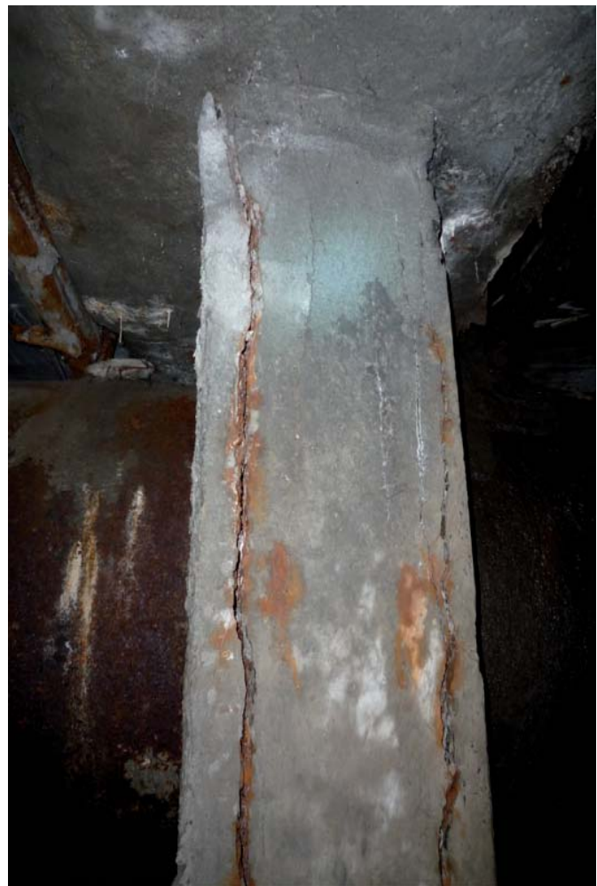
Рис. 12. Відшарування захисного шару, поздовжні тріщини у бетоні палі-стійки № 13 правобережної кінцевої ділянки
