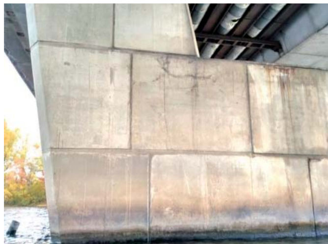
Рис. 8. Сліди замочування, руйнування захисного шару бетону та тріщини на надводній частині опори
