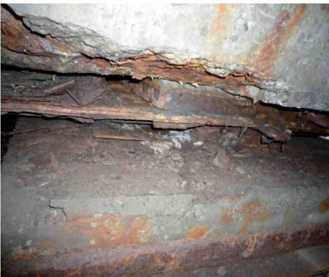
Рис. 11. Пластова корозія металевих пластин; засмічування ковзної поверхні опорної частини; виколи бетону на опорі 0
