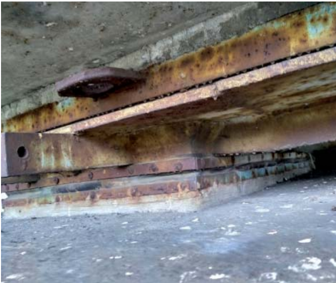
Рис. 10. Деформації гумових ущільнювачів в опорній частині опори № 1
